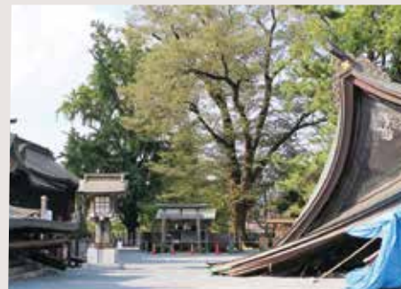
熊本地震後の楼門 九州で最大規模を誇っていた高さ約18mの二層式総檜造りの楼門は、震度7の熊本地震の本震で全倒壊しました。
