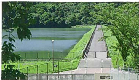
3 山の田(貯水池)堰堤、溢流路 やまのた(ちよすいち)えんてい(いづ)ゆらろ
