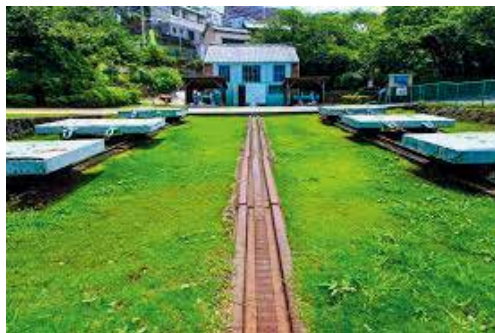
右／小菅修船場のドック曳揚げ機小屋の煉瓦 上／今も残る軌道 ○長崎県長崎市
