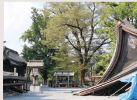
熊本地震後の楼門 九州で最大規模を誇っていた高さ約18mの二層式総檜造りの楼門は、震度7の熊本地震の本震で全倒壊しました。
