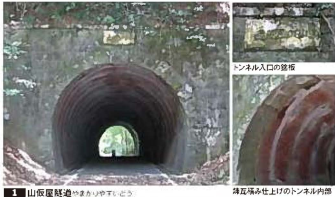
1 山飯屋隧道 やまひらやうすいどう 煉瓦積み仕上げのトンネル内部
